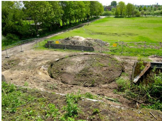
De verroeste Gastank, onder de zandwal, wordt zichtbaar. Rechts is nog net een stukje dak te zien van het oude Maaihok.
