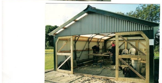
De nu definitieve Schuilhut, c.q. Hangaar, in aanbouw. (Theo Leenders, Jan Hermkens en Wim v. Hees bezig met de deuren).
