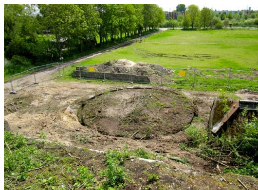
De verroeste Gastank, onder de zandwal, wordt zichtbaar. Rechts is nog net een stukje dak te zien van het oude Maaihok.
